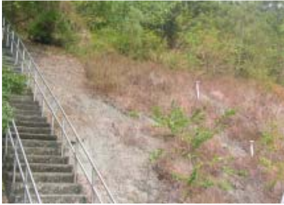
投池右岸邊坡表層沖蝕現象
