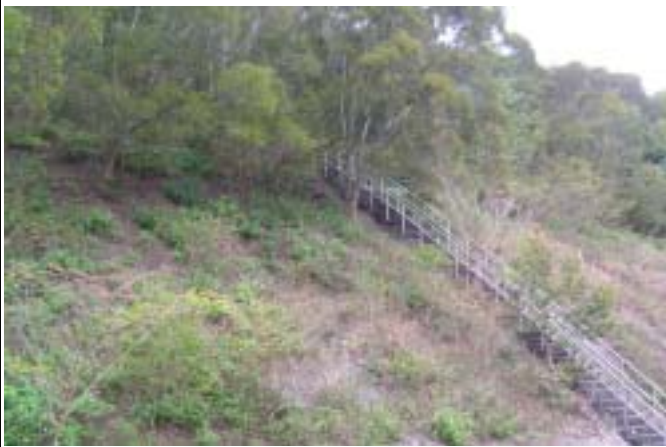
溢洪道右岸岩石裸露無明顯擴大跡象
