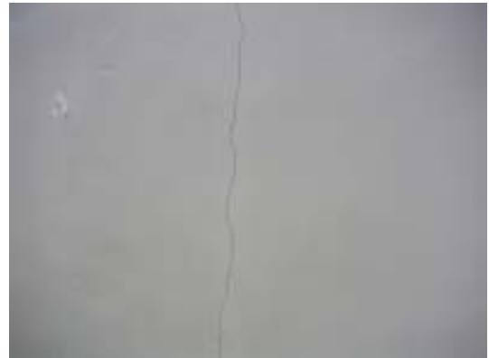
出水工閘門控制室外牆裂縫
