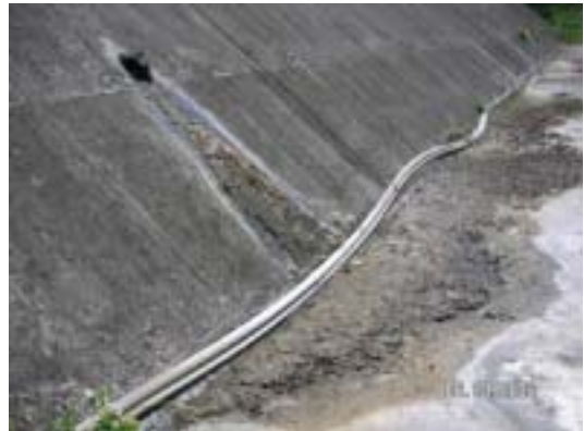
投池護岸洩水管有有機物質（含泥）流出
