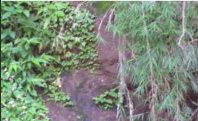
左壩座下游測無濕潤滲水現象
