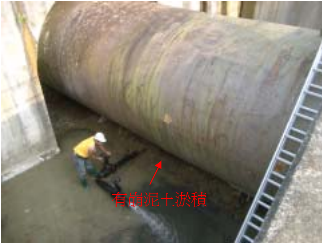
輸水路鋼管(曝露段)底部有崩泥土淤積情況
