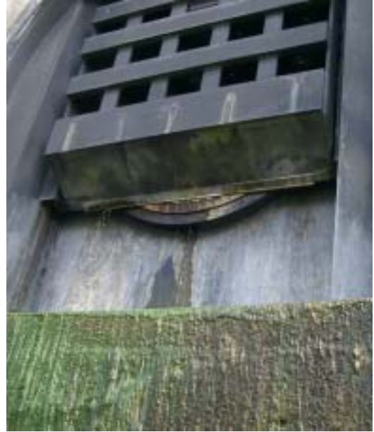
噴流閘門結構狀況正常但有些微漏水
