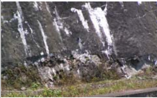
溢洪道左岸邊坡混凝土破損情形
