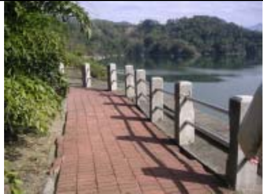
鋸齒堰右岸導牆背填土沈陷
