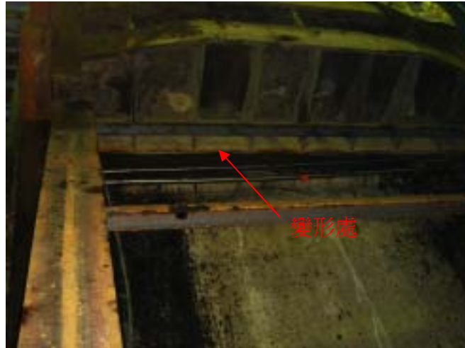
擋水閘門面板底部嚴重扭曲變形
