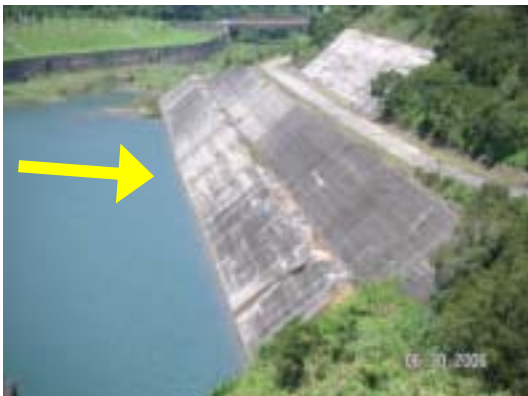
投池護岸線形疑有輕微之向外突出
