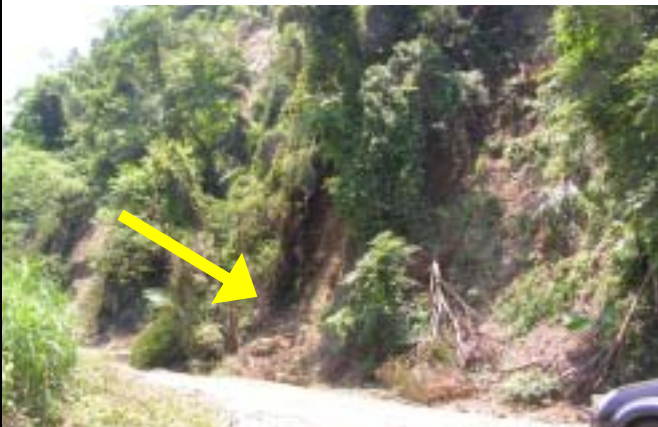
左壩座接近廊道入口處表層土石崩落
