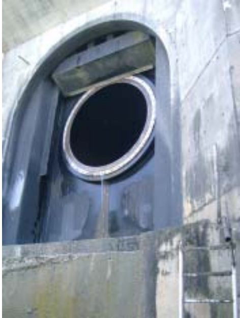
環閘閥漏水情況
