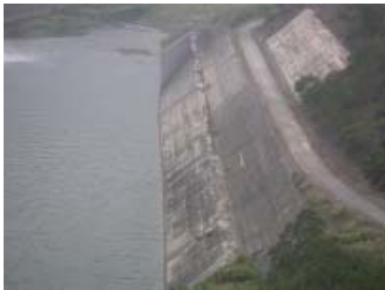
投池護岸線形疑有輕微之向外突出
