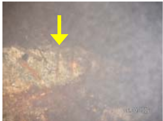
導水隧道混凝土襯砌 底版磨損露出鋼筋
