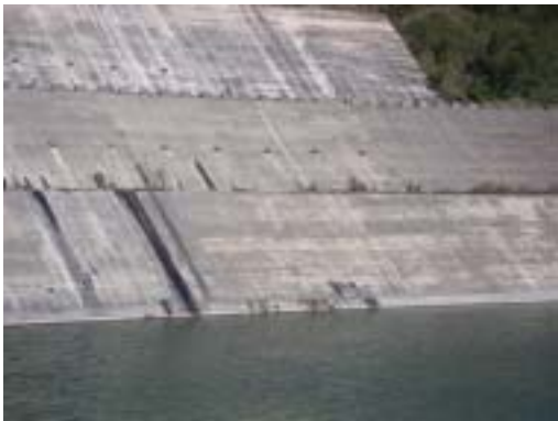
投池護岸混凝土既有裂縫
