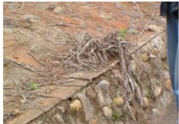
溢洪道兩岸邊坡之小裂隙
