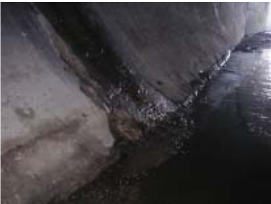
導水隧道仰拱襯砌磨損
