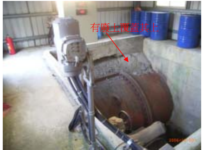
蝶閥連接段鋼管有廢土覆蓋其上現象
