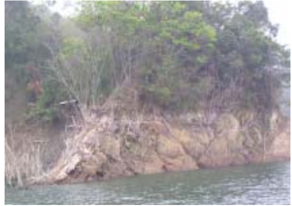
蓄水庫左岸邊坡局部岩石開裂現象
