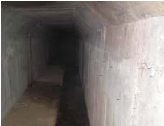
投池護岸線形疑有輕微之向外突出
