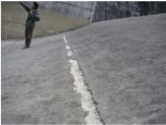
戽斗升層縫處混凝土剝落
