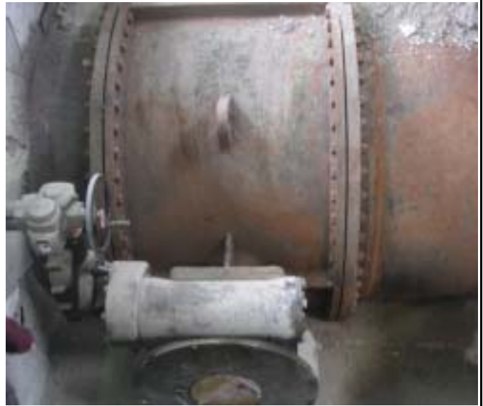
蝶閥連接段鋼管有全面銹蝕現象
