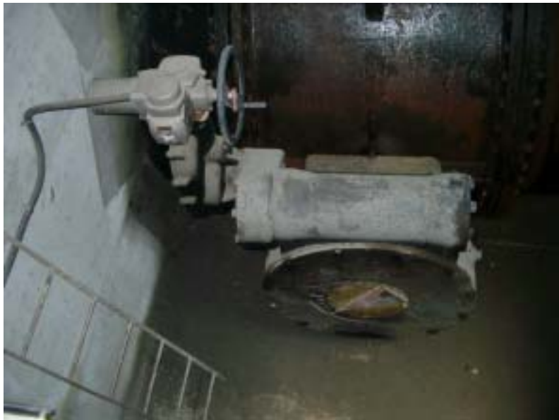
蝶閥閥體及蜗齒箱表面全面有生鏽現象
