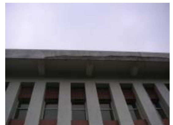
取水工操作房屋頂板外緣 混凝土或砂漿開裂、剝落
