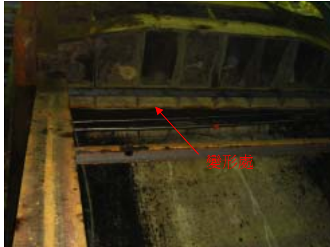
擋水閘門面板底部嚴重扭曲變形
