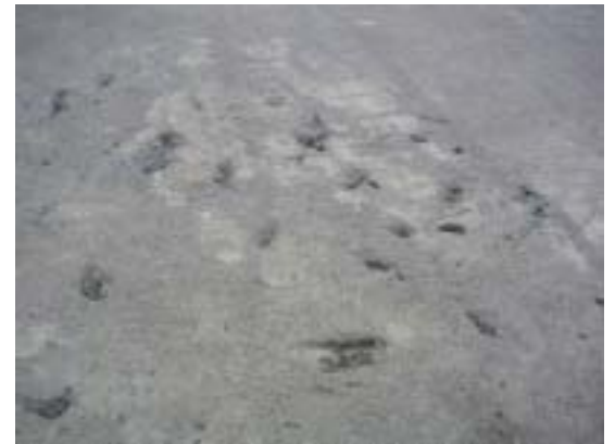
戽斗受硬物撞擊而產生之坑洞
