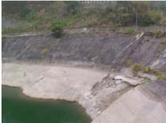
取水工左岸邊坡噴凝土局部開裂
