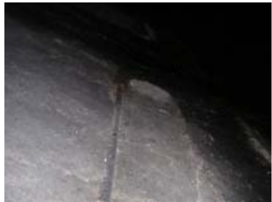
導水隧道襯砌露筋
