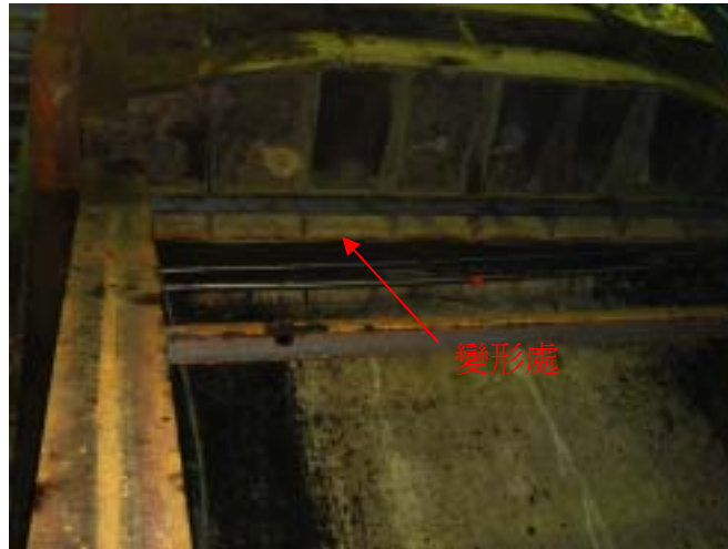
擋水閘門面板底部嚴重扭曲變形
