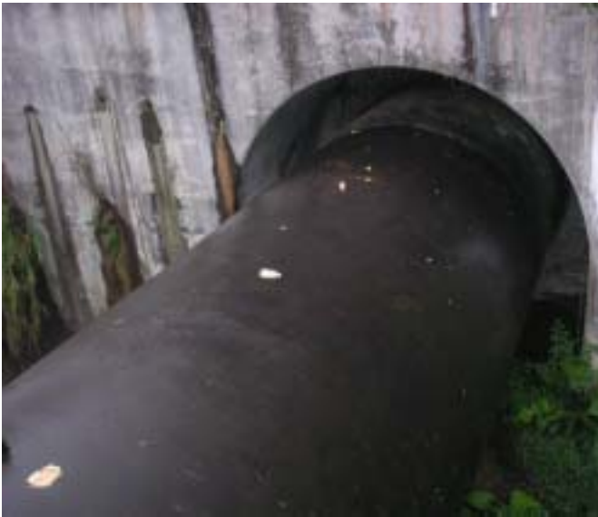
輸水路鋼管 (曝露段)油漆有老化現象
