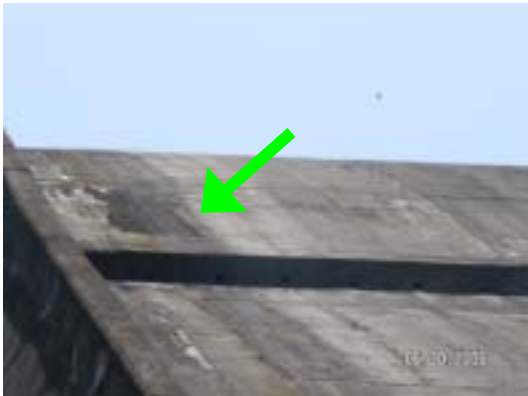
溢洪道明渠陡槽底版混凝土剝落
