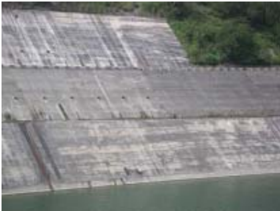
投池護岸混凝土既有裂縫
