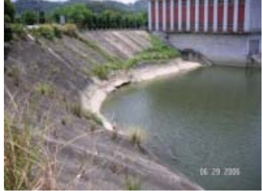
進水塔左岸護坡損壞情形
