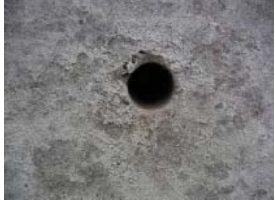
鋸齒堰部分模板螺栓孔未以砂漿回填
