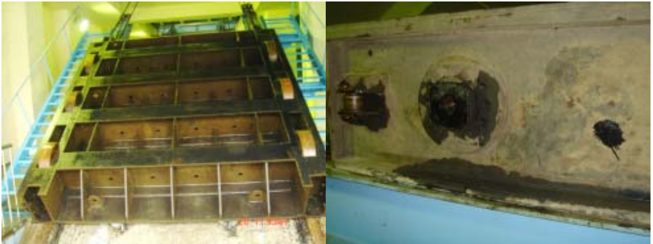
上層阻水閘門局部油漆剝落及老化現象
