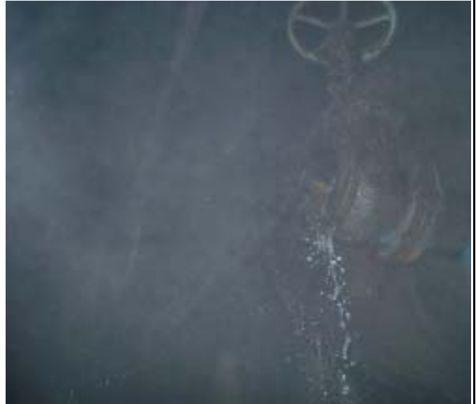
發電用水取水路壓力鋼管排水閥漏水情形
