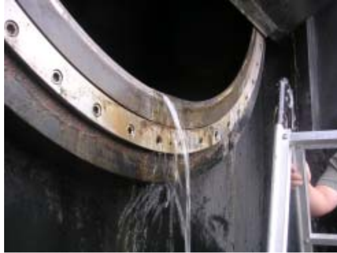
環閘閥漏水情況
