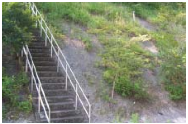
投池右岸邊坡表層沖蝕現象
