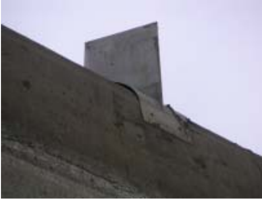
分水墩鋼板與混凝土間有間隙
