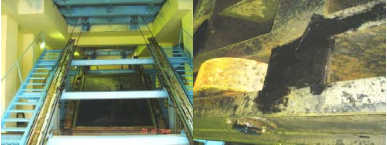
下層阻水閘門局部油漆剝落及老化現象
