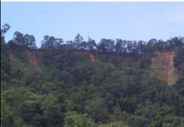
蓄水庫週邊右岸紅土礫石層表層沖蝕
